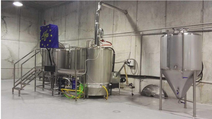
Figura 4: Microcervecera situada en las instalaciones de BDi Biotechnology
