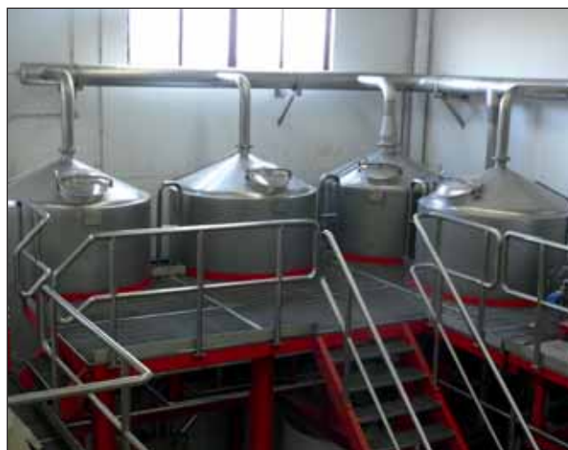
Foto 3. Vista general de calderas en sala de cocimiento. Planta Piloto AETCM.
