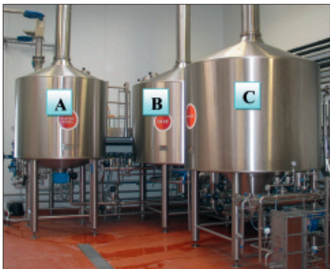
Figura 1.2. Sala de cocción de una fábrica de cerveza (caldera de mezcla A, caldera de filtración B, caldera de ebullición C) (cortesía de VELO SpA, Altivole, Italia).
